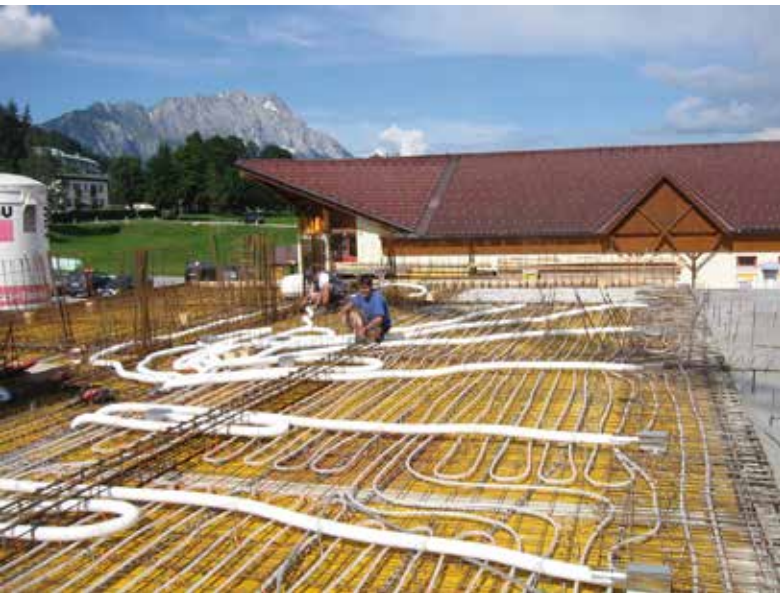
Abb. 3: In diesem Fall wurde auch die Verrohrung der Lüftung in die Betondecke integriert (zur großen Freude von Baumeister und Statiker)
