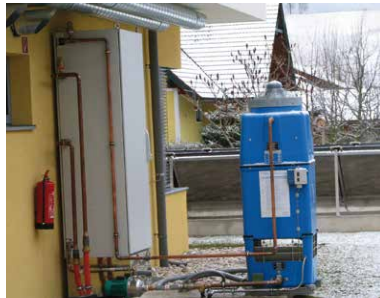
Abb. 4: Absorptionskältemaschine (Pink, Müzzuschlag) mit Kühlturm
