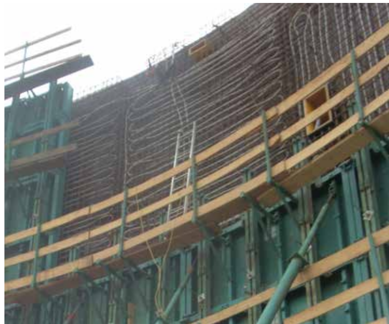
Abb. 6: Bauteilaktivierung im Zylinderbereich
